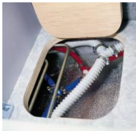
Geschraubt: Festgezogene Schellen halten Frisch- und Abwasser-schläuche auf den Verbindungsstücken (oben).
