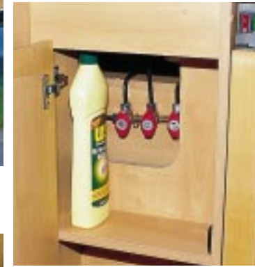
Die Gasabsperrhähne befinden sich hinter einer schützenden Holzeinfassung.
