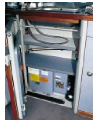
Gut gelöst: Die Bordelektrik sitzt leicht erreichbar unter der Spüle.
