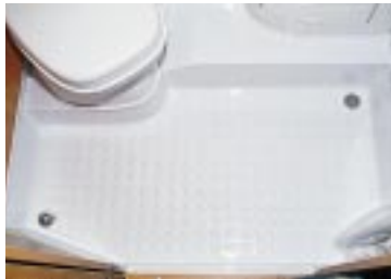
Die Duschtasse im Bad hat zwei Abflüsse.
