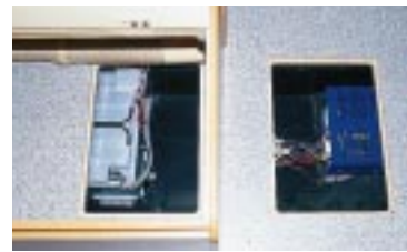
Die Bordelektrik sitzt im Funktionsboden.
