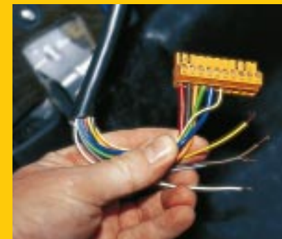
4 Die Kabel für Stromversorgung und Steuerung laufen in zwei Steckerleisten zusammen.
