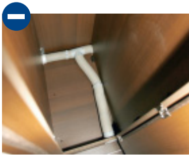
Sparversion: ungeschützte Warmluftschläuche unten im Kleiderschrank.
